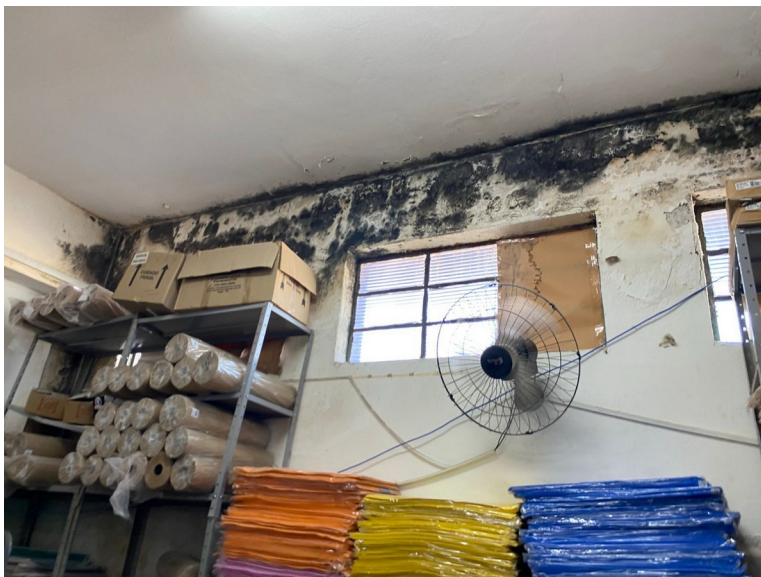
Infiltração e bolor no almoxarifado escolar
