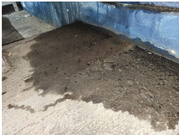
Infiltração no almoxarifado central
